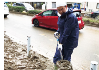
川崎市台風被害復旧ボランティア活動
